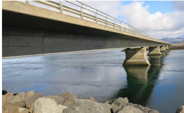
Mynd 6: Steypa í sjávarfallaumhverfi - Brú yfir Kolgrafafjörð. Steypt 2004 11 .
